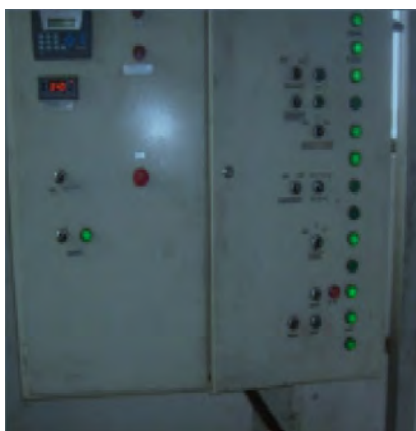
Upravljački sistem sa elektro ormanom
