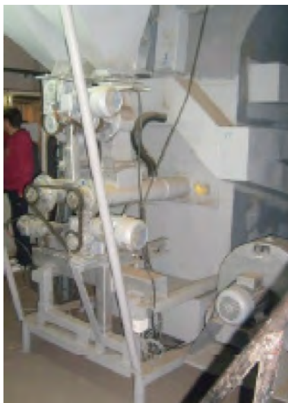
Sistem za doziranje energentom u ložište
