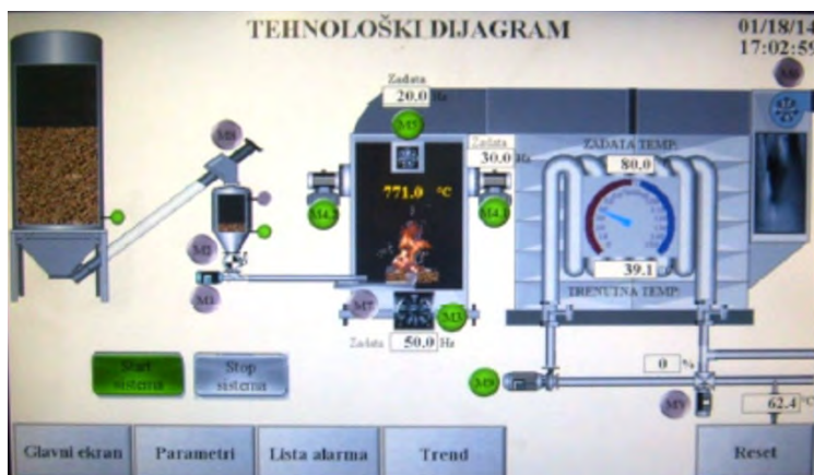
Digitalni sistem upravljanje procesom kotlovske jedinice
